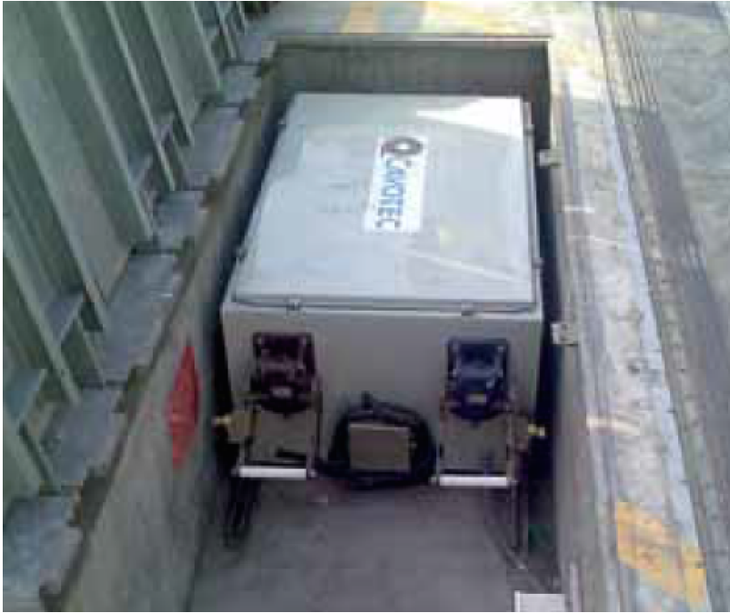
Figur 5. Nedgrävd anslutningspunkt som används då anslutningskabeln förvaras ombord (Cavotec, 2014).
